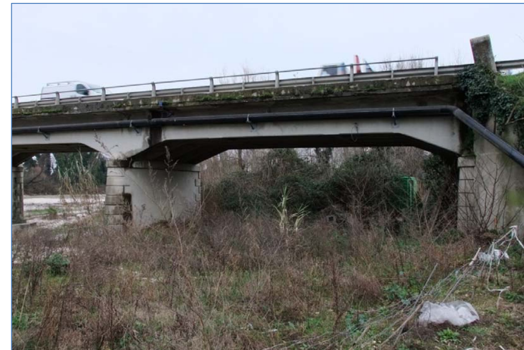
Foto B: Vista del ponte da Ovest con particolare della spalla dx in corrispondenza dell'area di sedime del nuovo tracciato stradale in valutazione.
