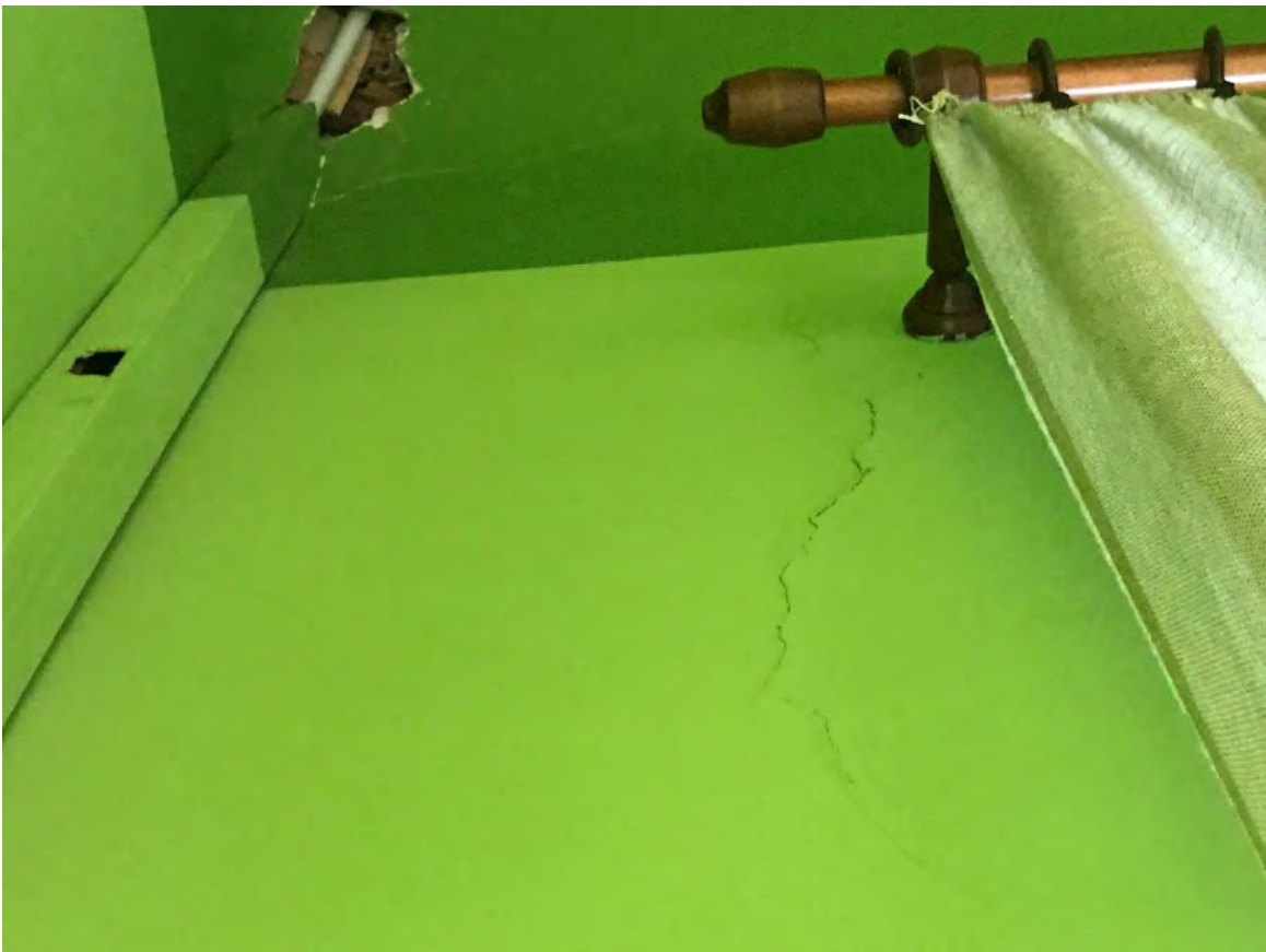
Figura 20: distacco orizzontamenti da murature portanti (cono ottico 18)
