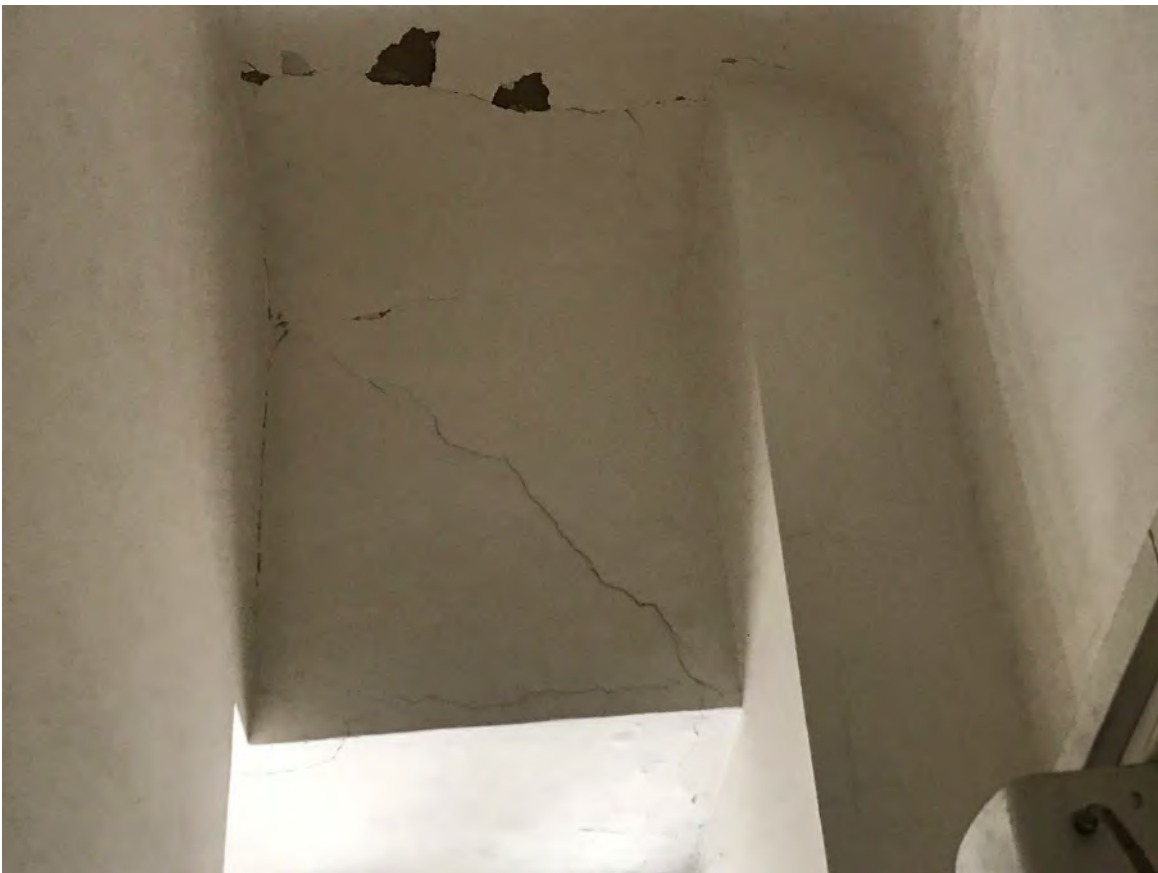
Figura 23: crisi per taglio della fascia di piano (cono ottico 21)
