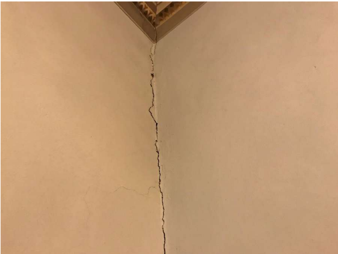
Figura 14: distacco di pareti ortogonali (cono ottico 12)
