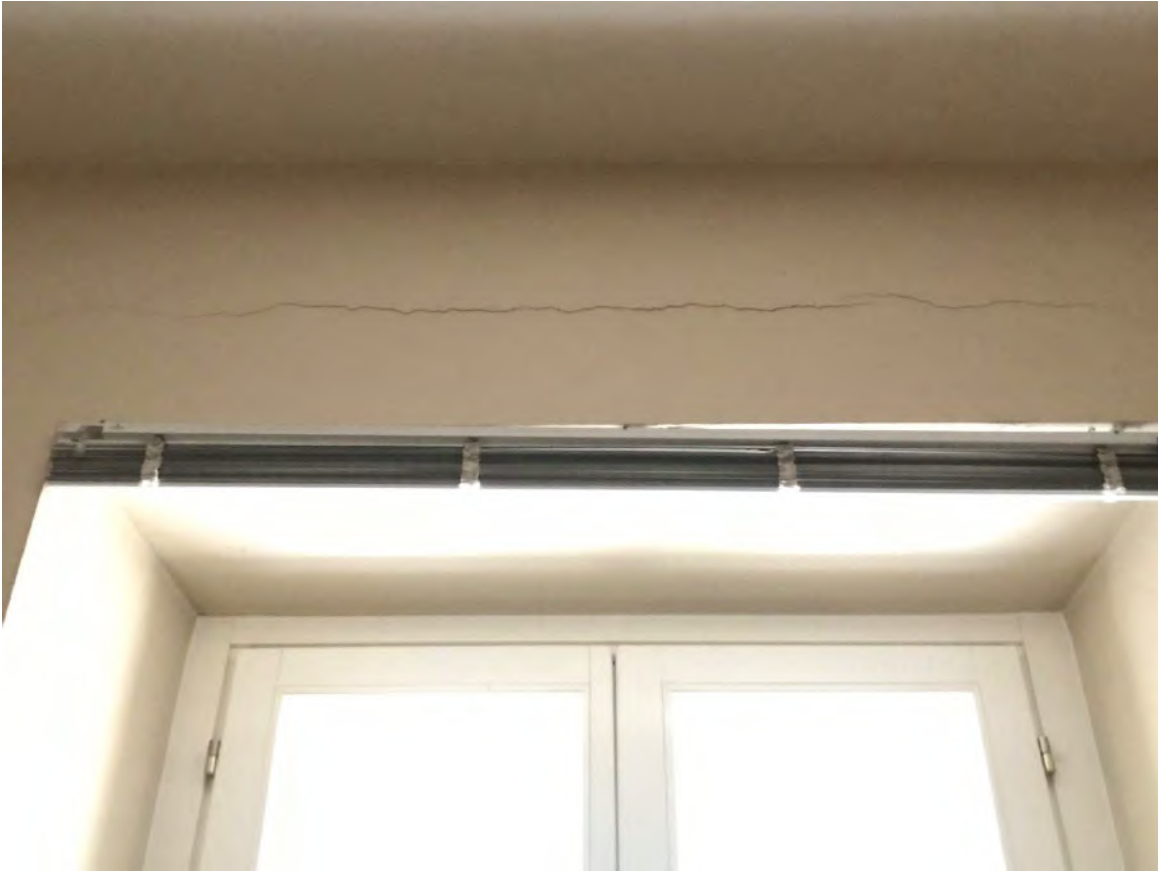
Figura 26: crisi per taglio della fascia di piano (cono ottico 24)
