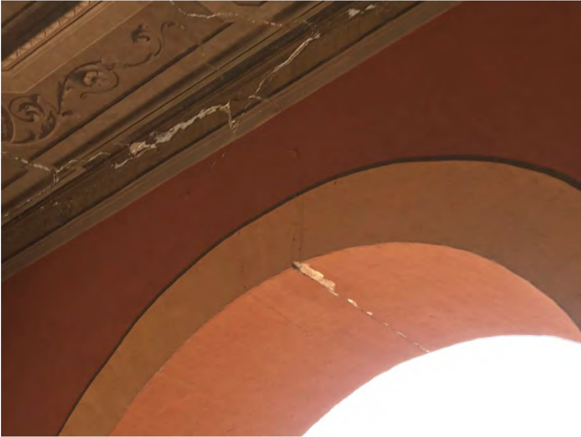
Figura 11: lesioni sui solai del loggiato passanti ed estese agli archi (cono ottico 9)
