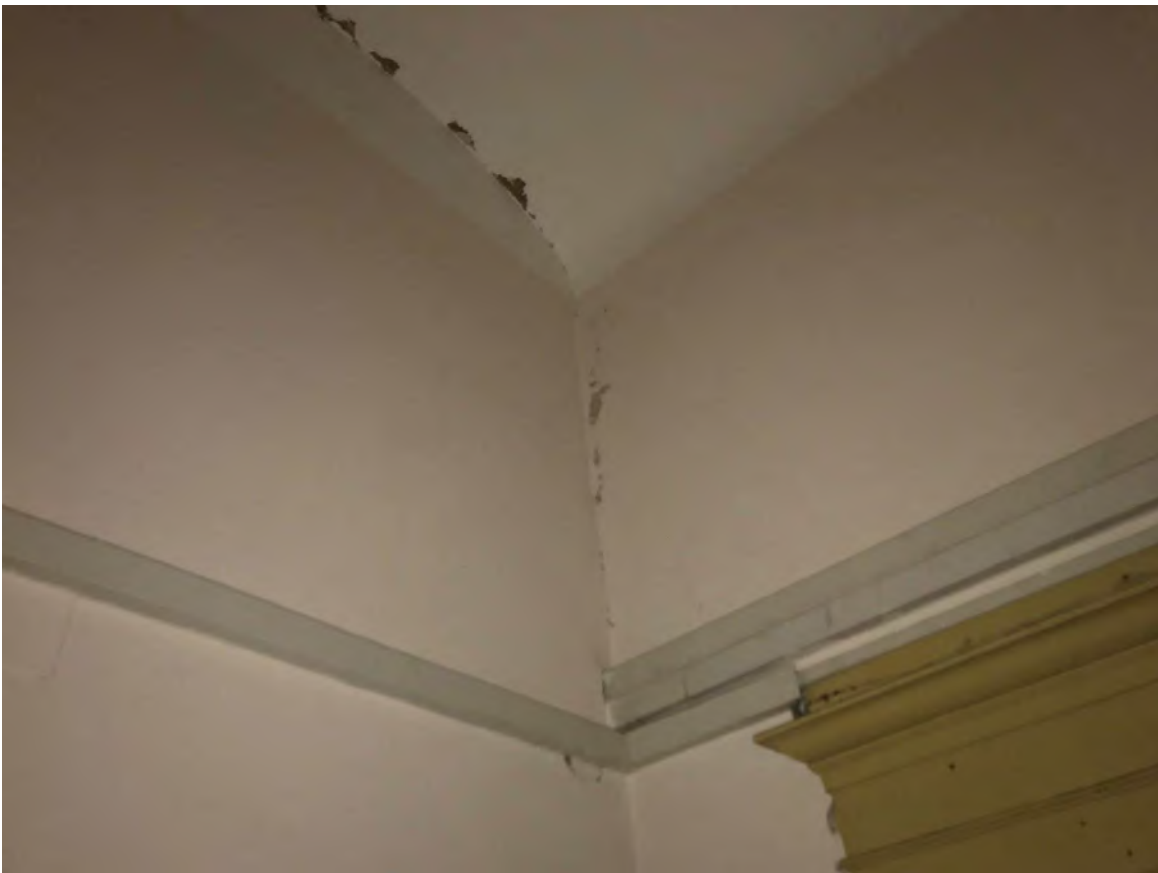
Figura 12: distacco orizzontamenti da murature portanti (cono ottico 10)
