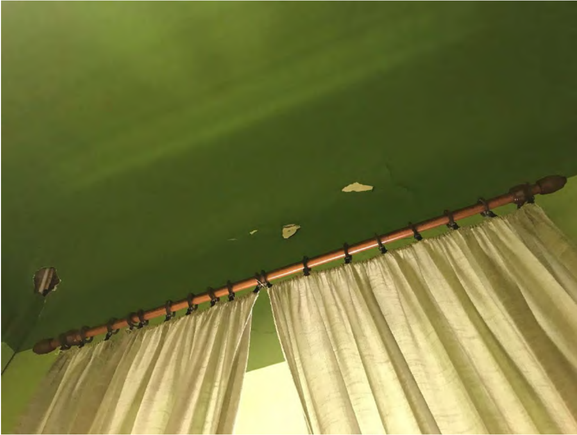
Figura 19: distacco orizzontamenti da murature portanti (cono ottico 17)
