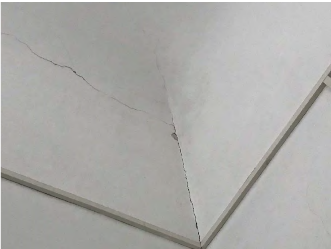
Figura 8: distacco di pareti ortogonali (cono ottico 6)
