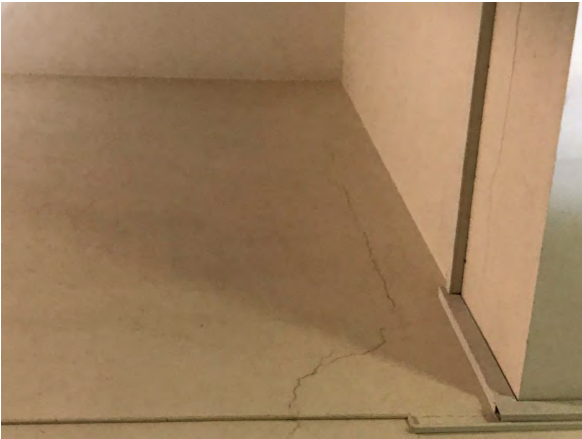
Figura 24: lesioni in corrispondenza del vano scala (cono ottico 22)
