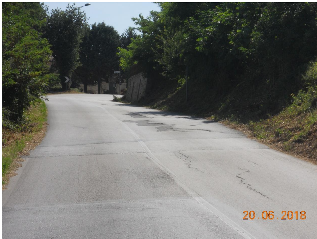
Foto 3. Km 27+700 - Avvallamenti della pavimentazione stradale, deterioramento dei rappezzi, sgranamento ed usura dello strato superficiale.
