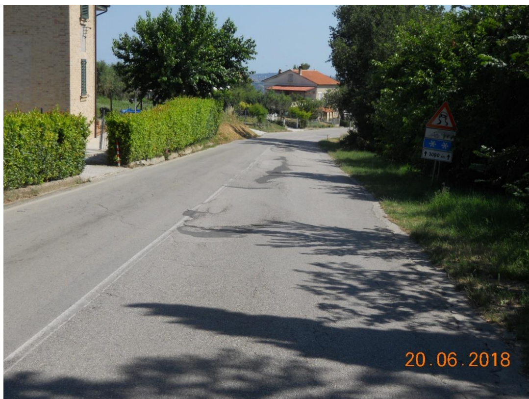
Foto 1. Km 27+100 - Avvallamenti della pavimentazione stradale, deterioramento e distacco dei rappezi ed usura dello strato superficiale.
