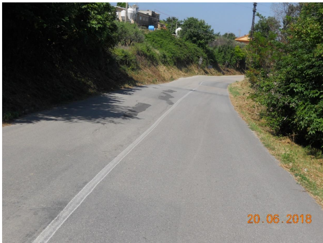
Foto 2. Km 27+700 - Avvallamenti della pavimentazione stradale, deterioramento dei rappezi ed usura dello strato superficiale.
