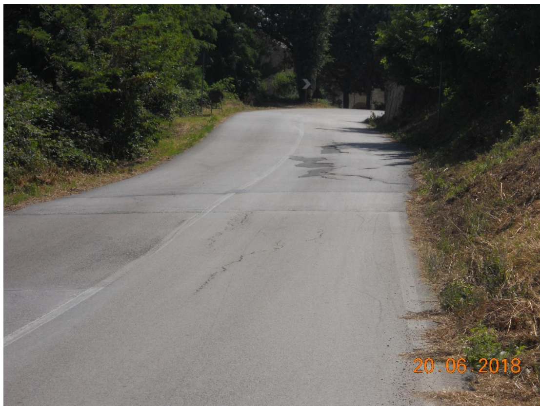
Foto 4. Km 27+700 - Avvallamenti della pavimentazione stradale, deterioramento dei rappezzi, fessurazione, sgranamento ed usura dello strato superficiale.
