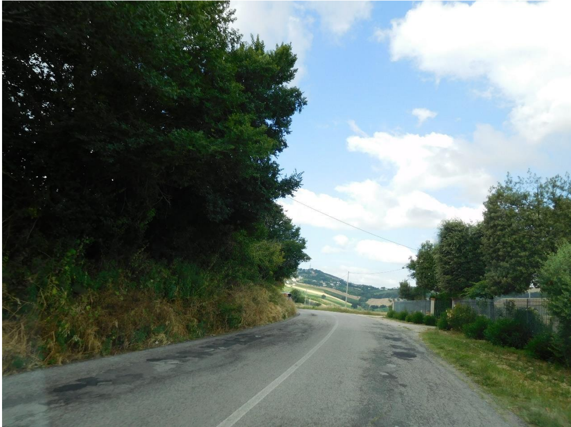
Foto 7. S.P. 11 - Km 6+000 - Fessurazione del bordo della pavimentazione stradale con deterioramento e distacco dei rappezzi.
