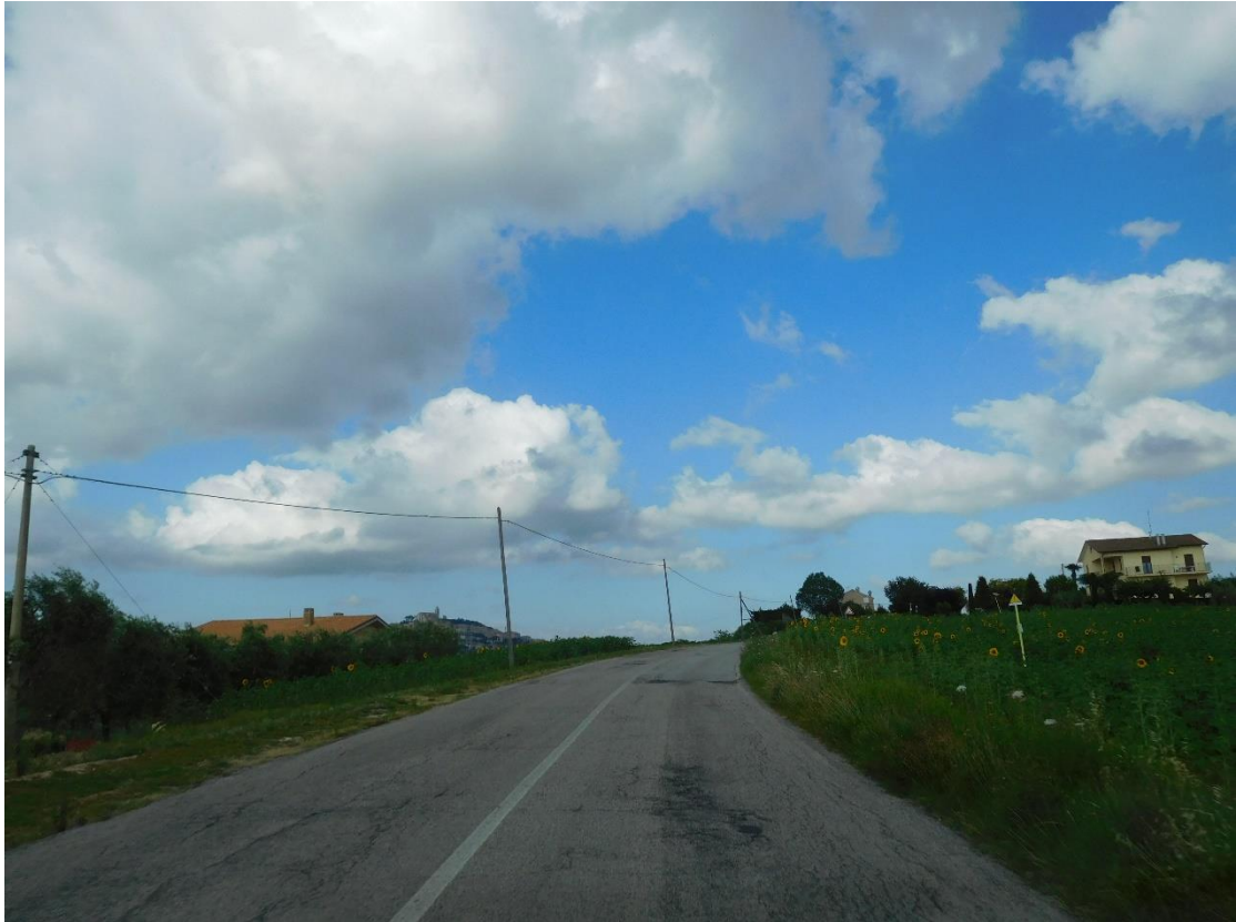
Foto 5. S.P. 11 - Km 5+800 - Fessurazione diffusa della pavimentazione stradale.
