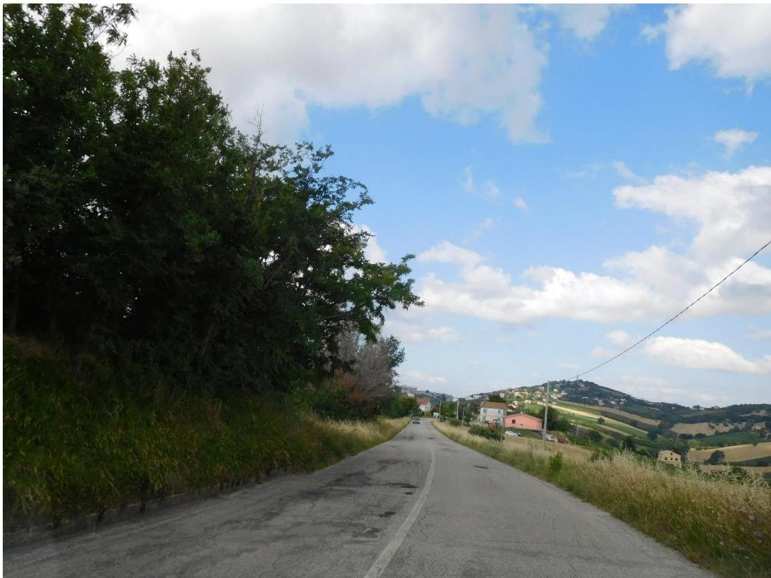
Foto 8. S.P. 11 - Km 6+000 - Fessurazione del bordo della pavimentazione stradale con deterioramento e distacco dei rappezzi.
