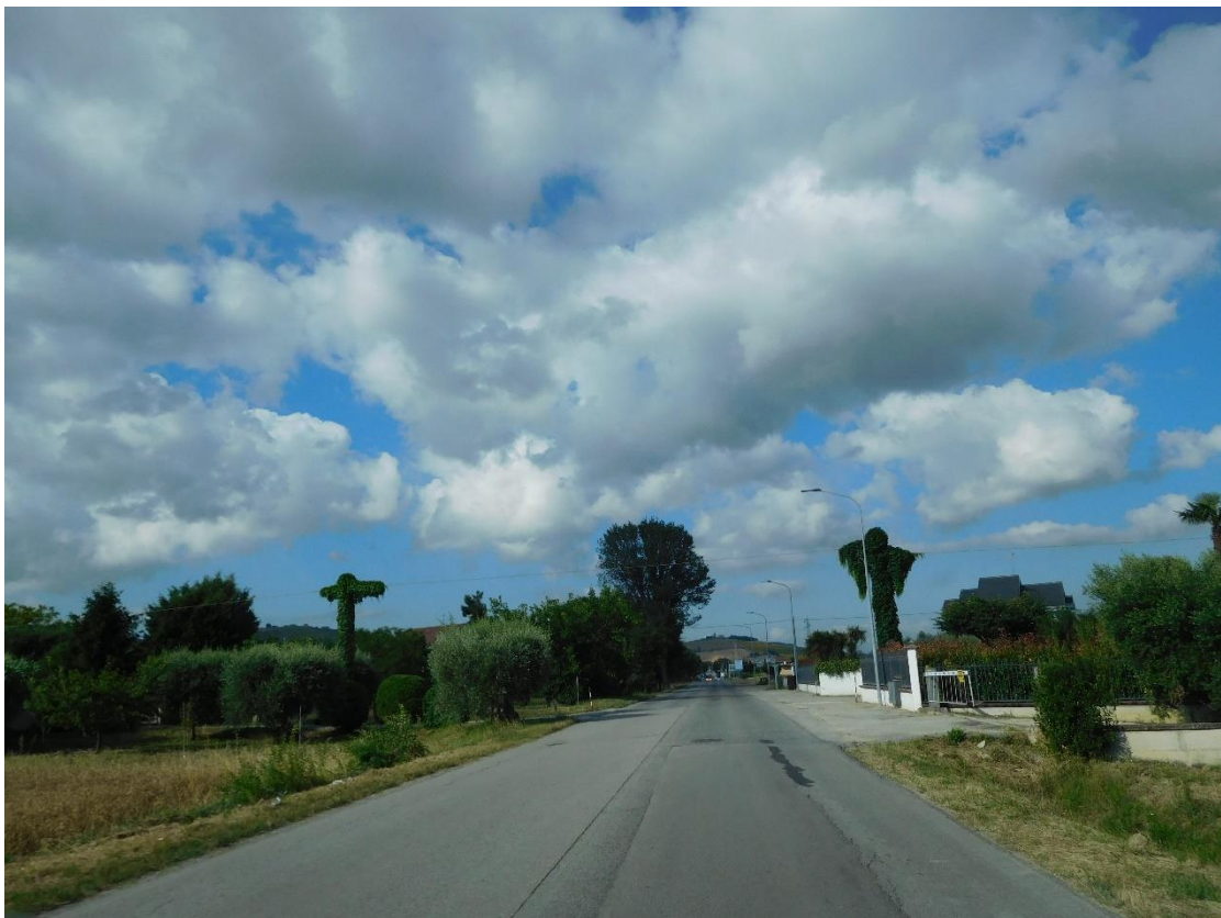
Foto 15. S.P. 224 - Km 1+800 - Discontinuità della superficie del piano viario connesse alla realizzazione di sottoservizi.
