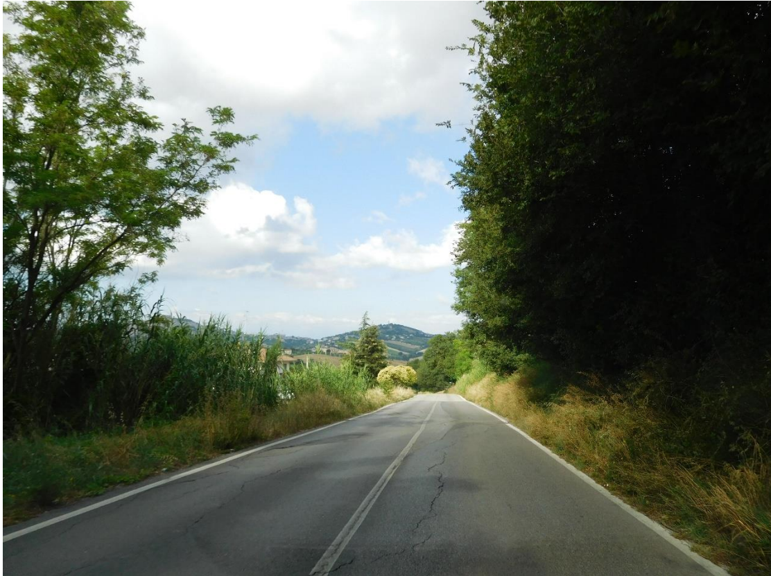
Foto 3. S.P. 11 - Km 4+800 - Avvallamenti della pavimentazione stradale con distacchi dello strato superficiale di usura.
