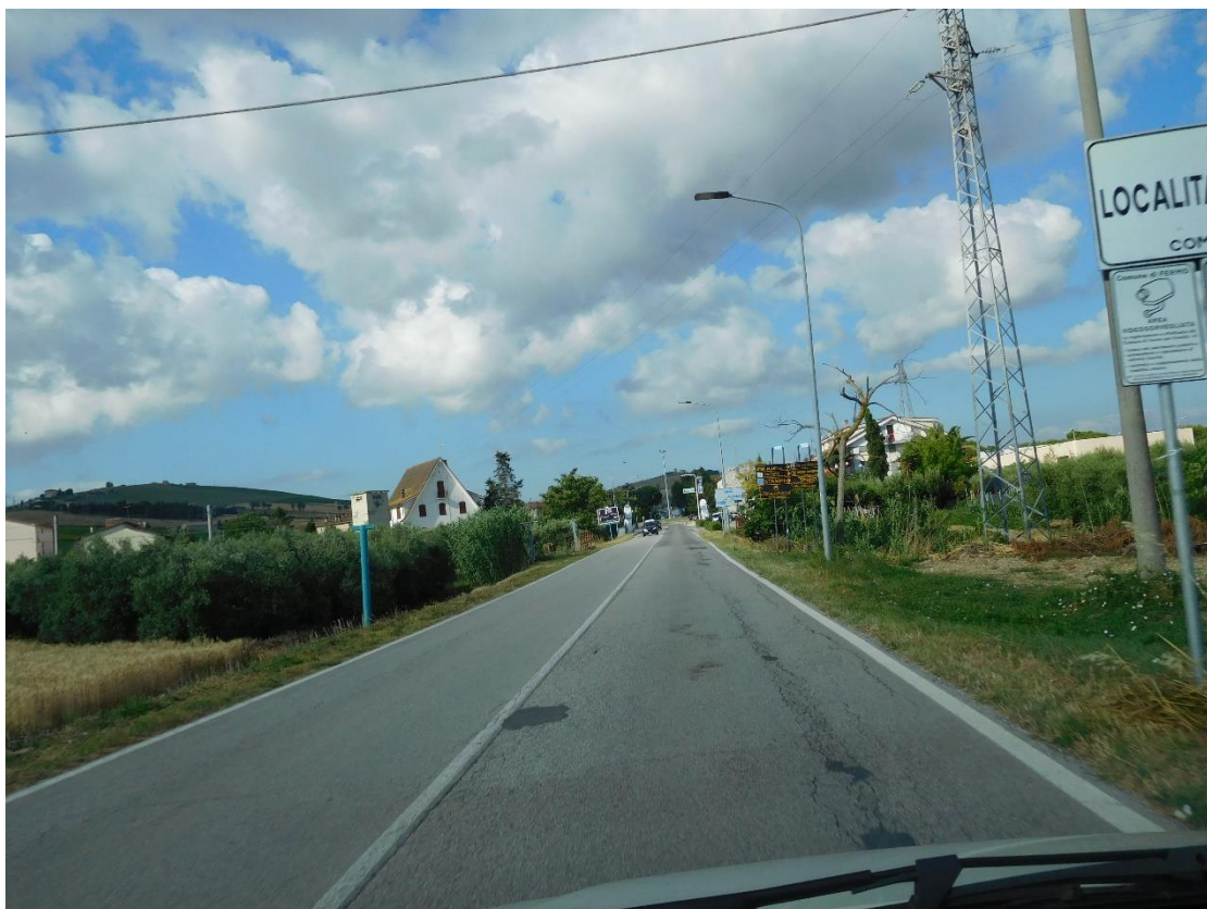
Foto 17. S.P. 224 - Km 2+350 – Fessurazione della pavimentazione stradale.
