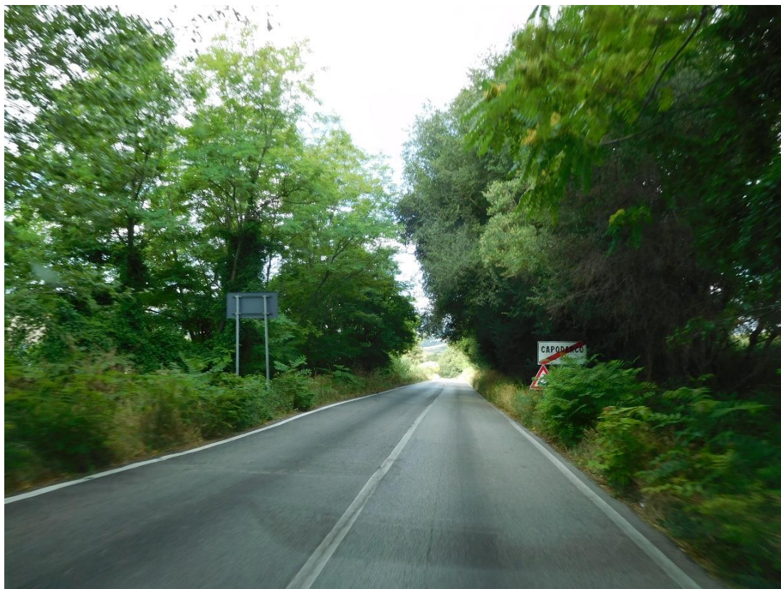
Foto 1. S.P. 11 - Km 4+700 - Avvallamenti della pavimentazione stradale con fessurazione longitudinale.
