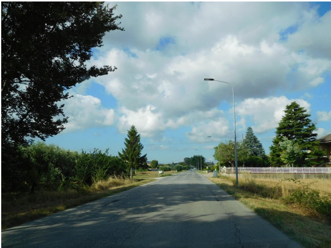
Foto 13. S.P. 224 - Km 1+200 - Fessurazione longitudinale della pavimentazione stradale con evidenze di sgranamento ed usura della superficie.
