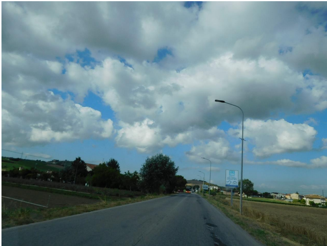
Foto 16. S.P. 224 - Km 1+900 - Fessurazione del bordo della pavimentazione stradale, distacco e deterioramento dei rappezzi ed usura dello strato superficiale.
