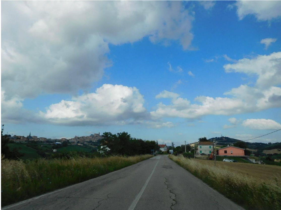
Foto 9. S.P. 11 - Km 6+250 - Avvallamenti della pavimentazione stradale con fessurazione longitudinale e fessurazione del bordo.
