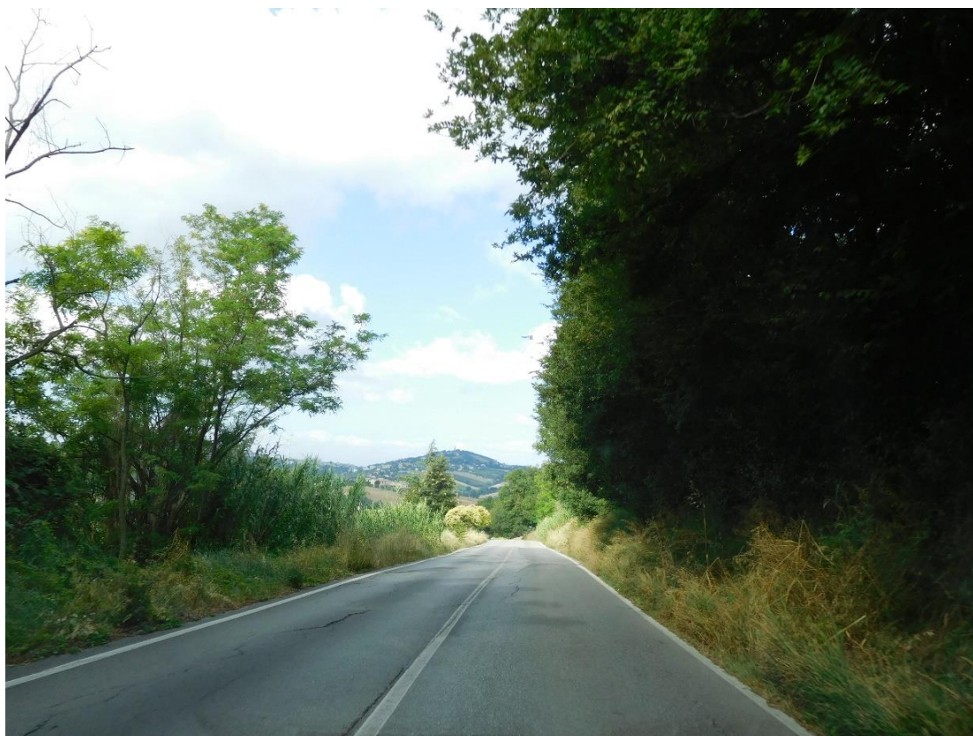
Foto 1. S.P. 11 - Km 4+800 - Avvallamenti della pavimentazione stradale con distacchi dello strato superficiale di usura.
