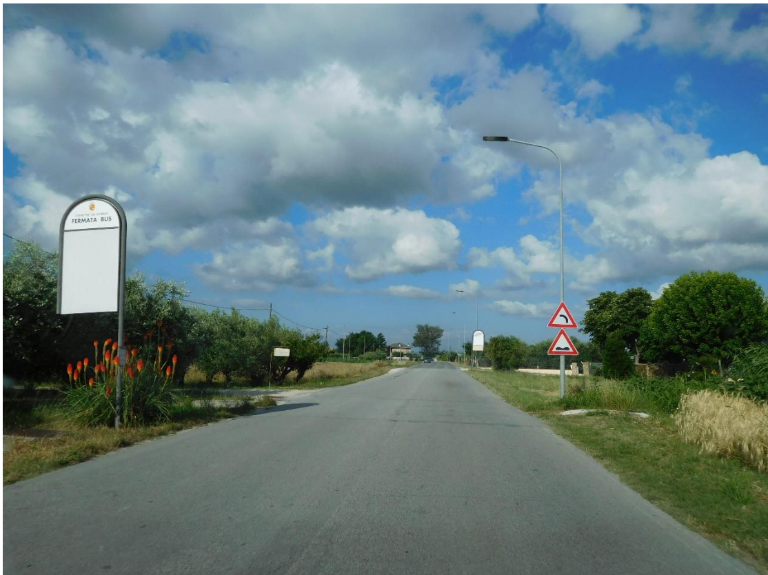
Foto 10. S.P. 224 - Km 1+100 - Usura della superficie della pavimentazione stradale.
