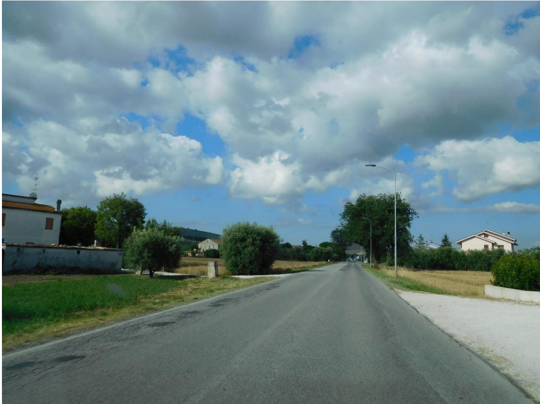
Foto 14. S.P. 224 - Km 1+800 - Fessurazione a ragnatela del bordo della pavimentazione stradale, deterioramento e distacco dei rappezzi, evidenze di ormaiamento ed usura della superficie.
