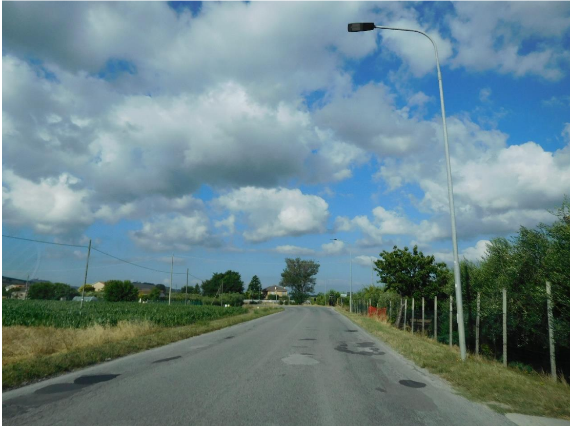
Foto 11. S.P. 224 - Km 1+200 - Avvallamenti della pavimentazione stradale connessi alla realizzazione di sottoservizi, usura dello strato superficiale e deterioramento e distacco dei rappezi.
